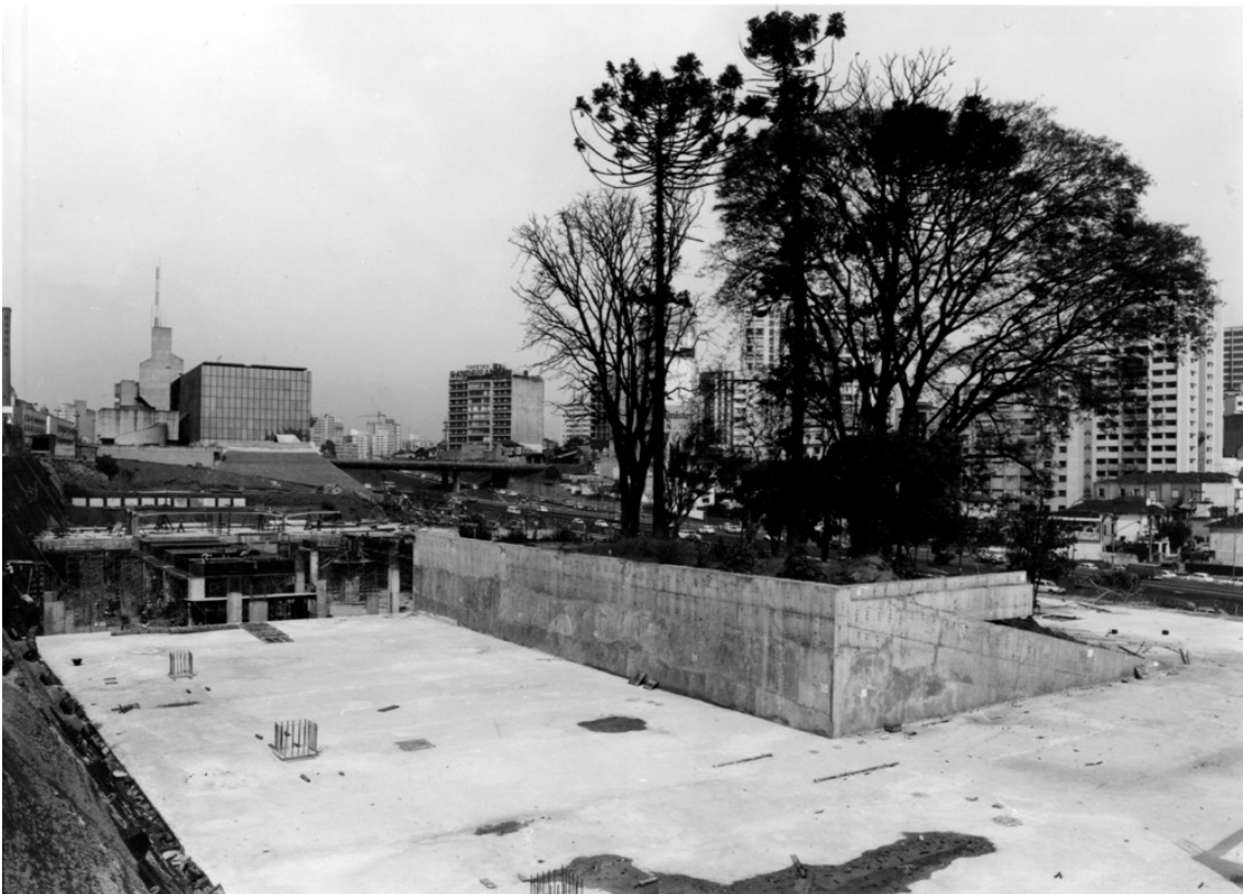
Construção Centro Cultural São Paulo. Na foto vê-se o jardim que foi deixado no meio da obra. Esse jardim era original do terreno. Foto: Waldemir Gomes de Lima
